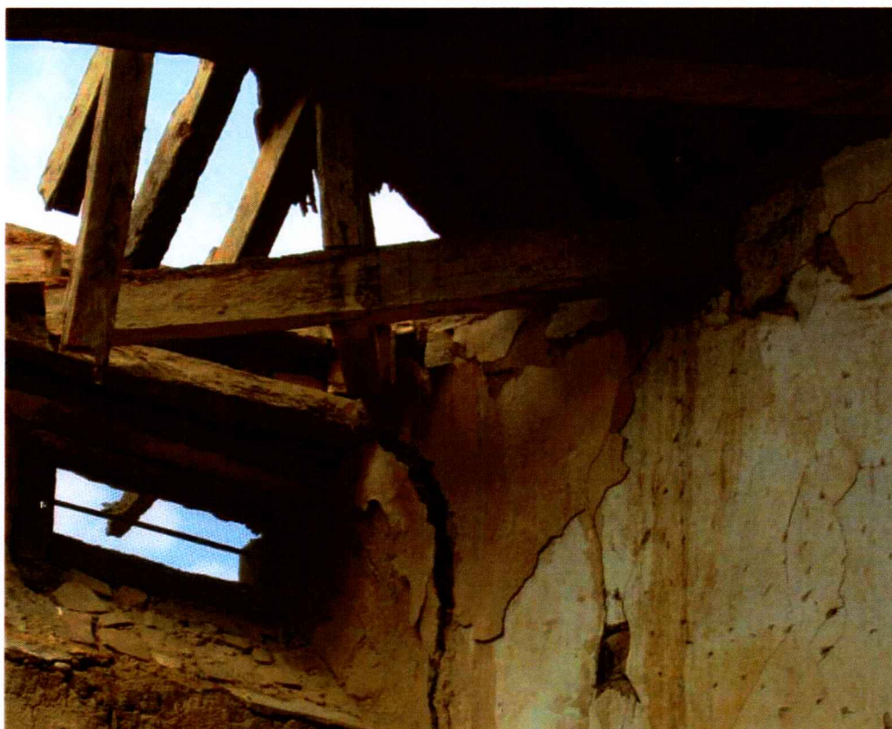
Otro aspecto de la cubierta arruinada y grietas en el lado Oeste del palacio
