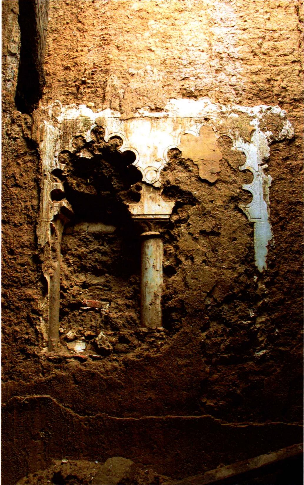
Detalle de la arquía aparecida recientemente, expuesta directamente a la lluvia y otros agentes que están degradando muy rápidamente los revocos.
